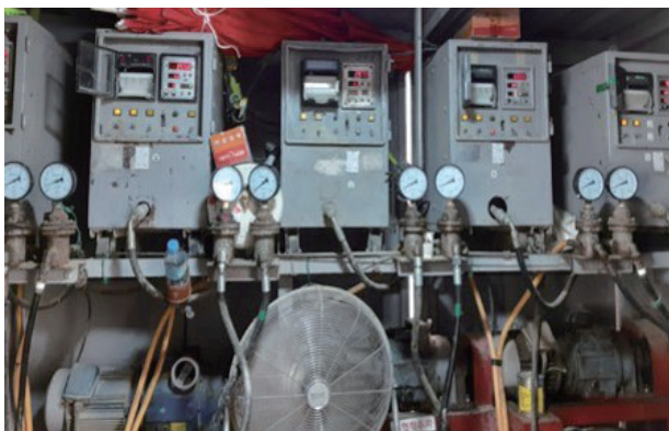
(T.S.M 주입펌프 및 유량계)
